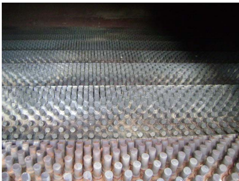
Figura 12 – Horno F-1 Refinería Campana, estado final limpieza de los tubos de superficie extendida de la zona convectiva
