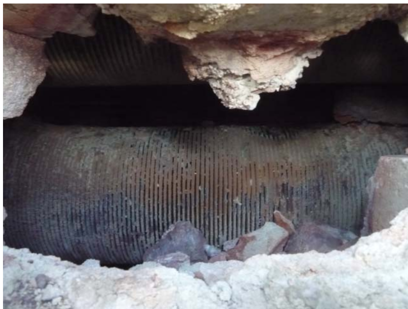
Figura 7 – Horno F-101 Refinería Campana, estado inicial de los tubos de la zona convectiva
