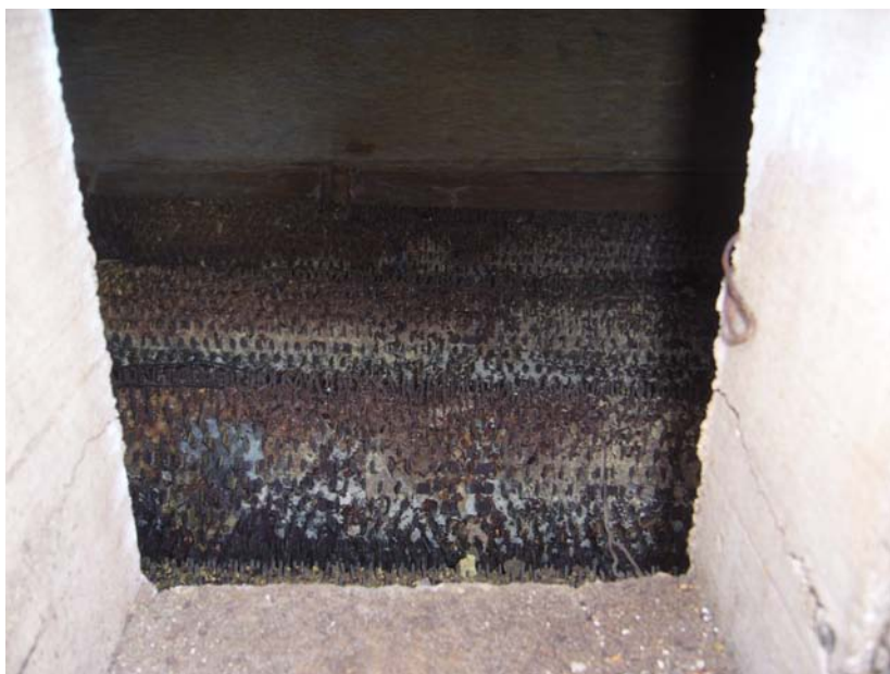
Figura 19 - Horno BA 461 Refinería La Plata, estado tubos de superficie extendida de la zona convectiva antes de la limpieza
