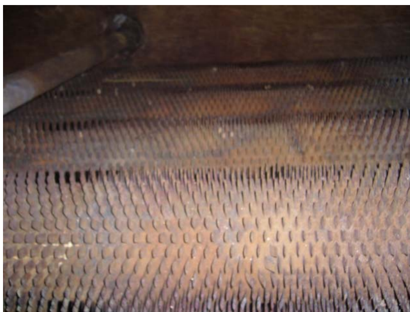
Figura 21 – Horno BA 461 Refinería La Plata, estado de los tubos de superficie extendida de la zona convectiva luego de la limpieza.
