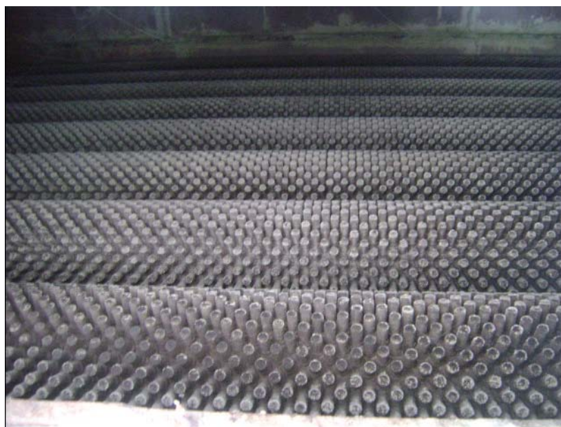
Figura 10 – Horno F-1 Refinería Campana, esta inicial de los tubos de superficie extendida de la zona convectiva
