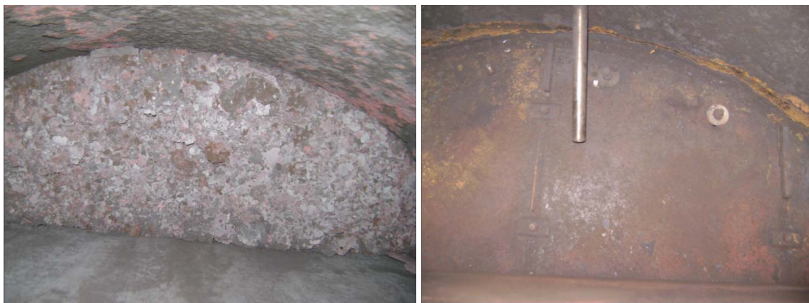
Figura N°4: izquierda, downcomer como fue encontrado. Derecha, downcomer una vez limpio
