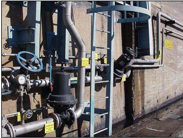
Vista de las válvulas de habilitación de cada pico
