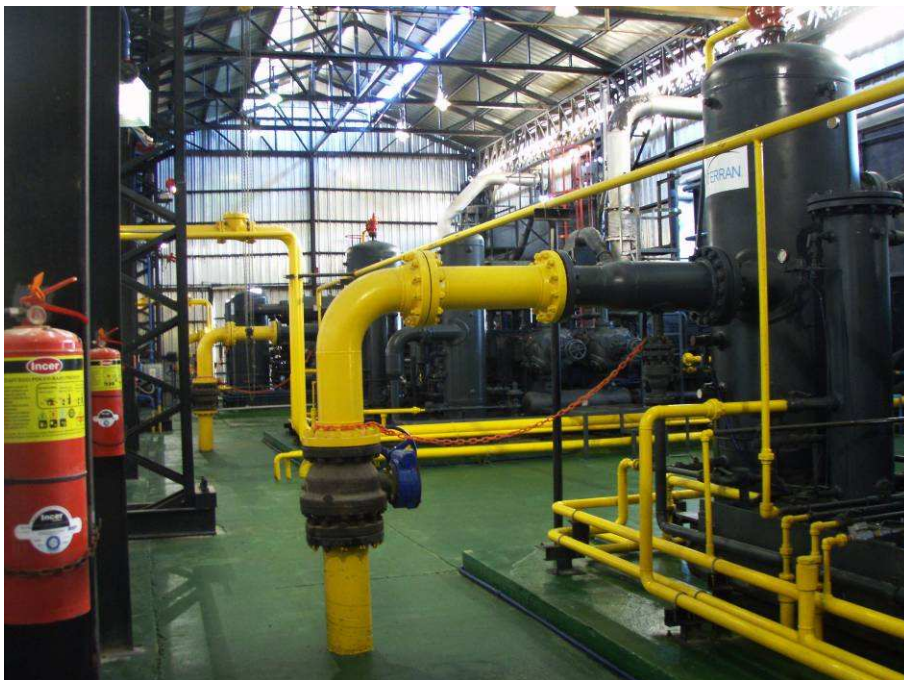
Fotos 9. Aspecto de la sala de Motocompresores. Cuenta con sensores de llama y mezcla explosiva, con señal en el SCADA de la Planta, asociados a lógica de paro y venteo.
