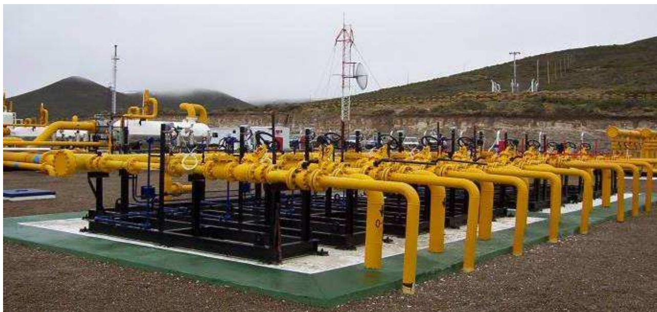
Foto 8. Vista de los skid de inyección. Al fondo separadores de gas, luminarias y antena de radio.
