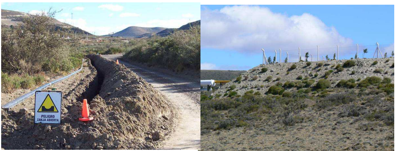
Foto 3. Gasoducto instalado sobre la banquina de un camino secundario del yacimiento.
