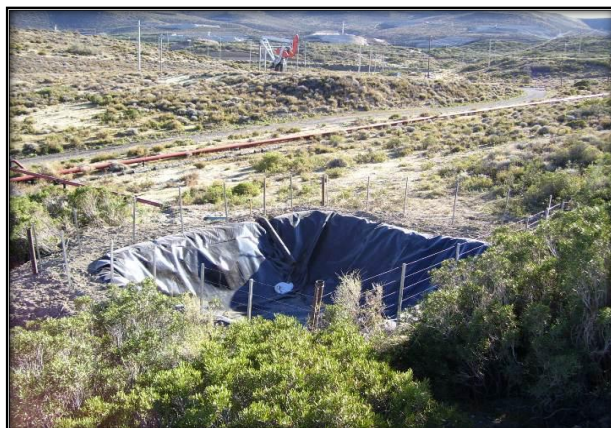
Foto 4: Vista de unos de las piletas de contención secundaria construidas.
