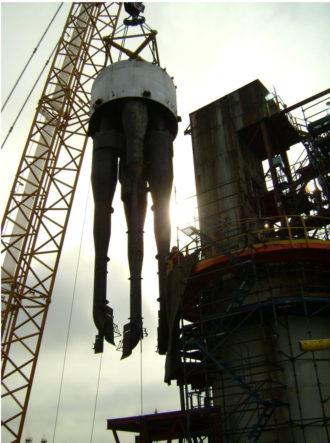
Fig. 27 : Elevación del conjunto cabezal-ciclones.
