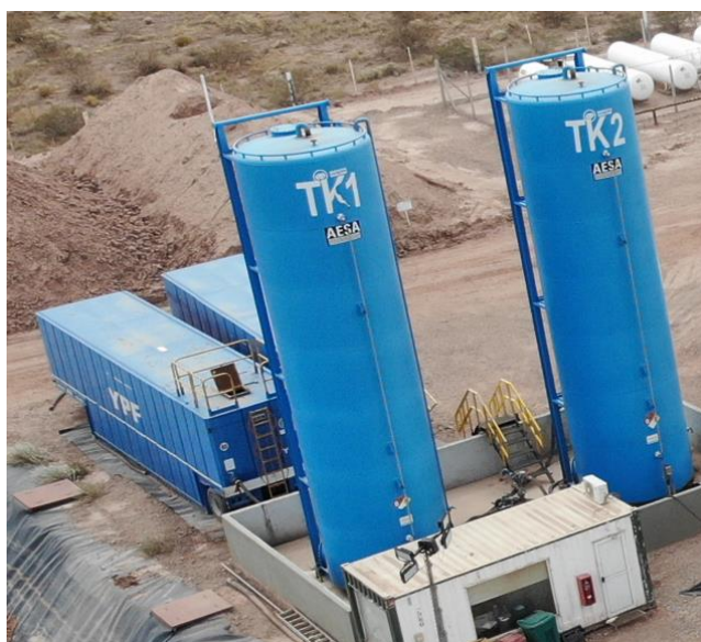
Fotografía 9 - Tanques de recuperado OIL.
