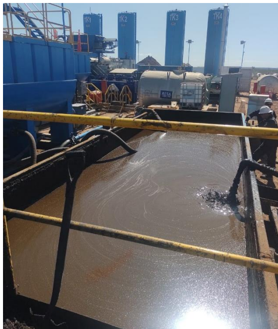
Fotografía 6 - Pileta de descarga
