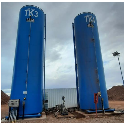
Fotografía 5 - Tanques de almacenamiento de agua residual
