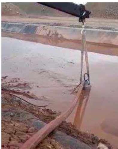
Fotografía 1 – Bomba lodos sumergida en pileta soterrada.
