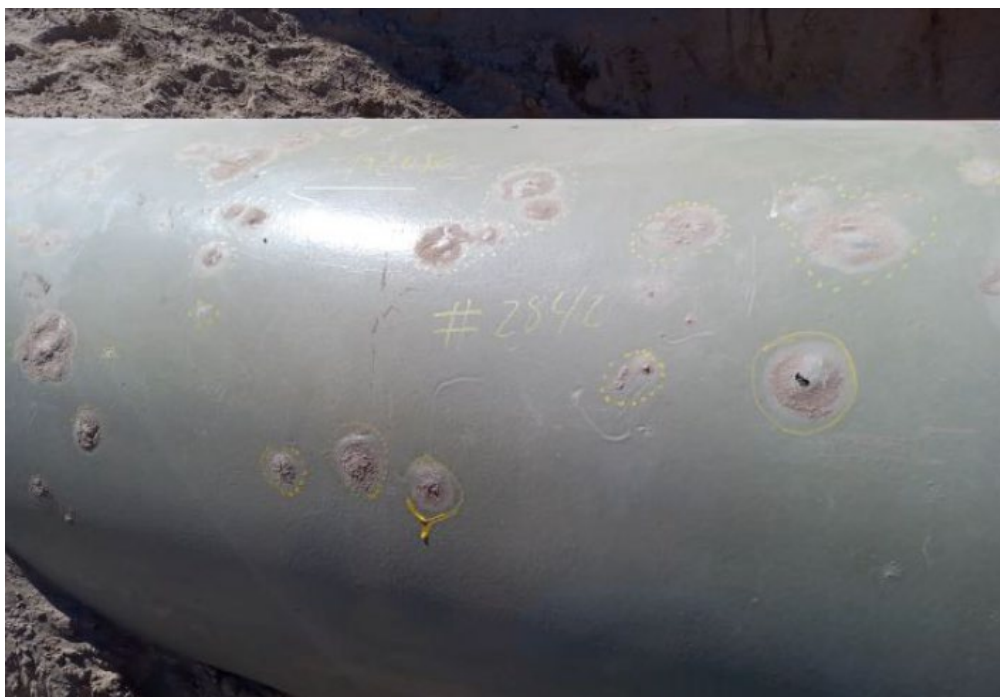
Figura 8: Ampollas en ducto revestido con pintura epoxi.
