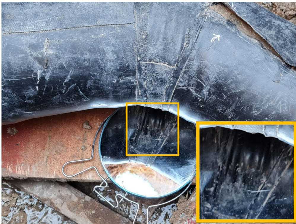
Figura 16: Uso incorrecto de una manta termocontraíble sobre un accesorio. Se observan arrugas en la parte inferior del codo.
