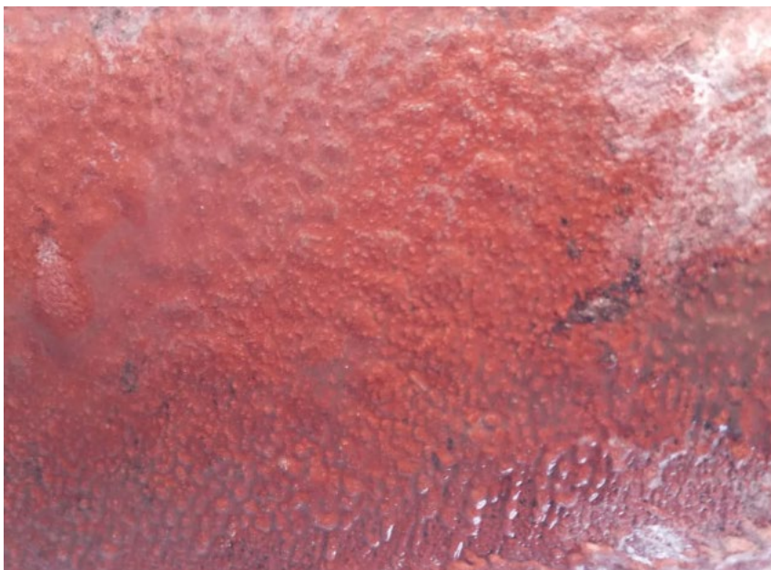
Figura 11: Superficie revestida con espesor insuficiente de epoxi. Se observan además chorreaduras y ampollas.
