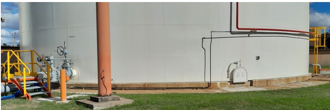
Fig. 8 tanque 74, con doble fondo realizado en 2023
