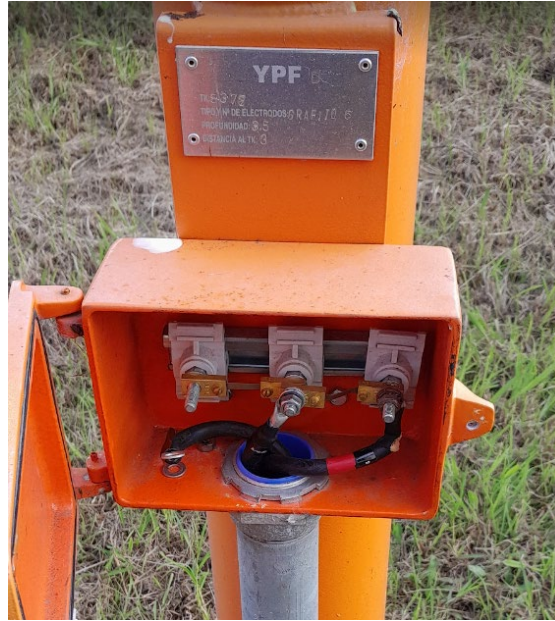
Fig. 6 - Caja de Distribución anódica, entrada a tanque.
