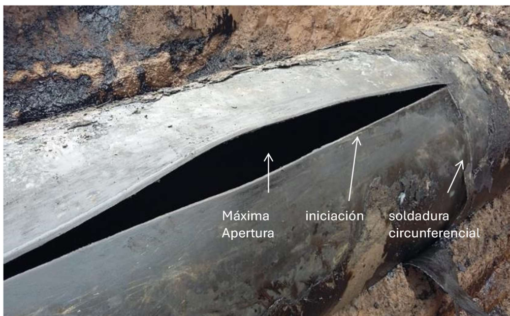
Fig. 7: Fisura adyacente a la costura longitudinal
