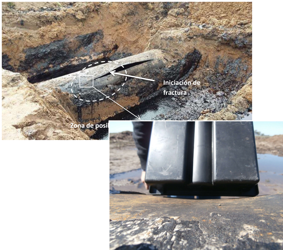
Fig. 19: Evidencia visual de deformación superficial
