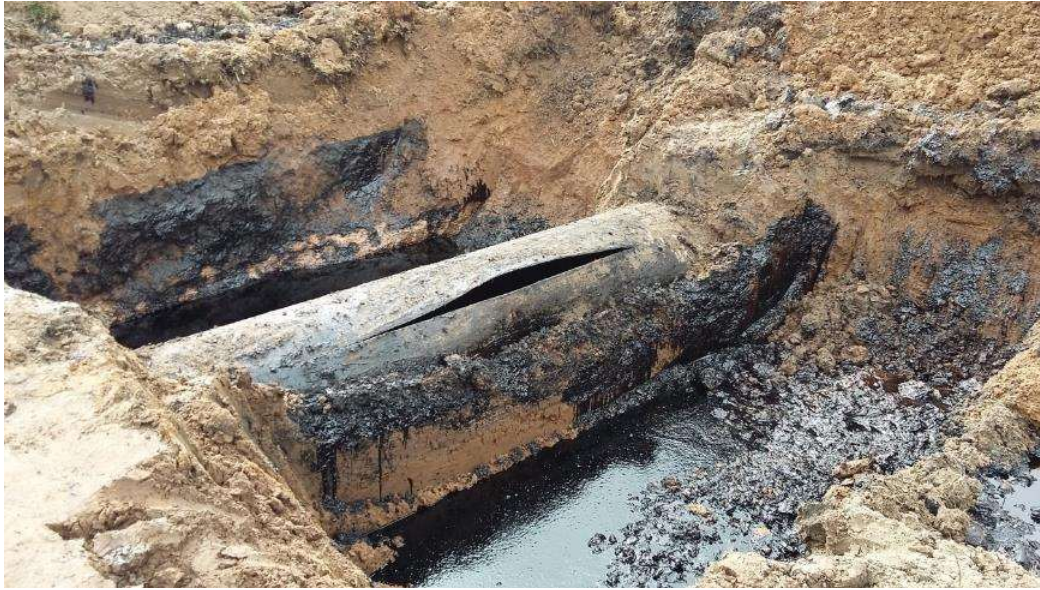
Fig. 2: Fisura localizada en la ZAC de la costura longitudinal
