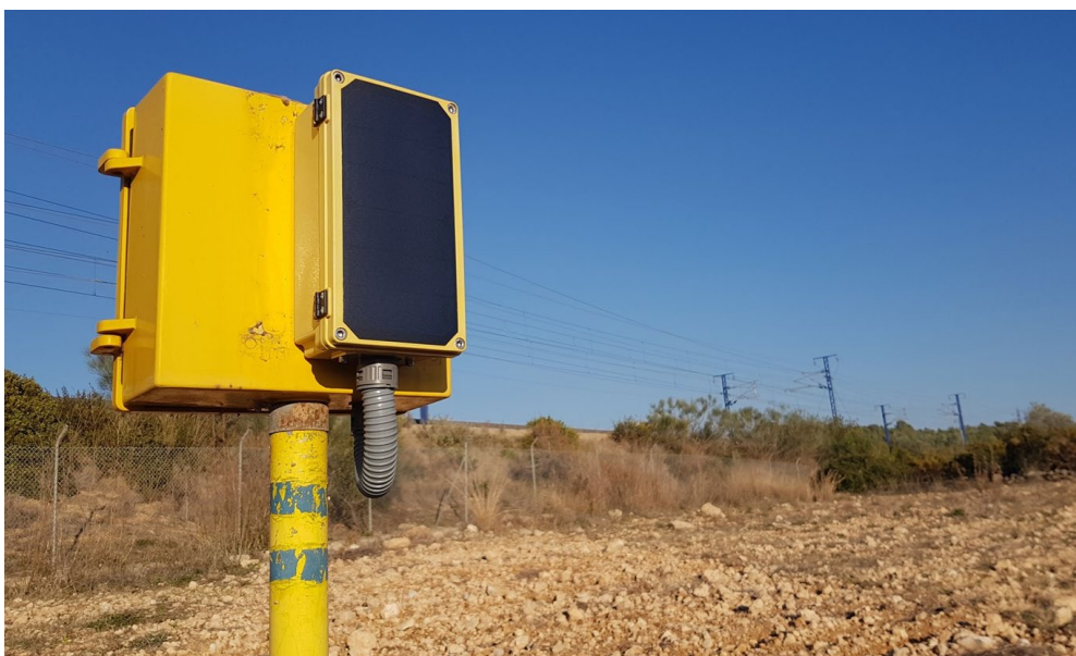
Figura 1 - Estación de pruebas equipada con un pequeño panel solar
