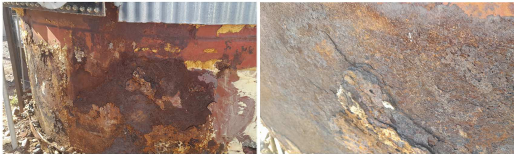
Imagen 2 - Tanque con corrosión bajo aislación
