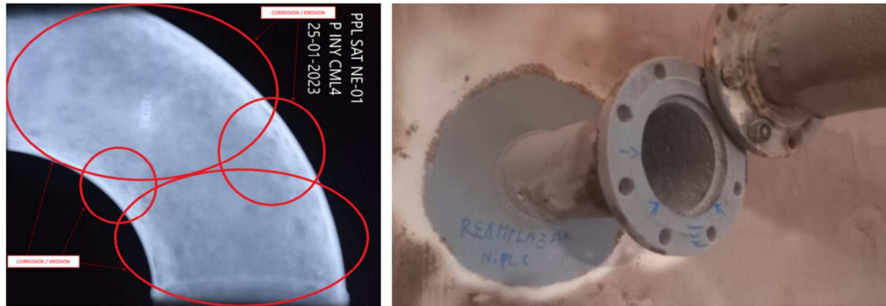
Imagen 1 - Ejemplos de corrosión generalizada en piping y niple de tanque
