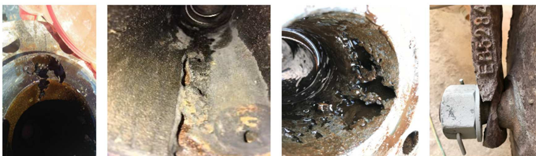
Imagen 4 - Ejemplos de fallas en válvulas
