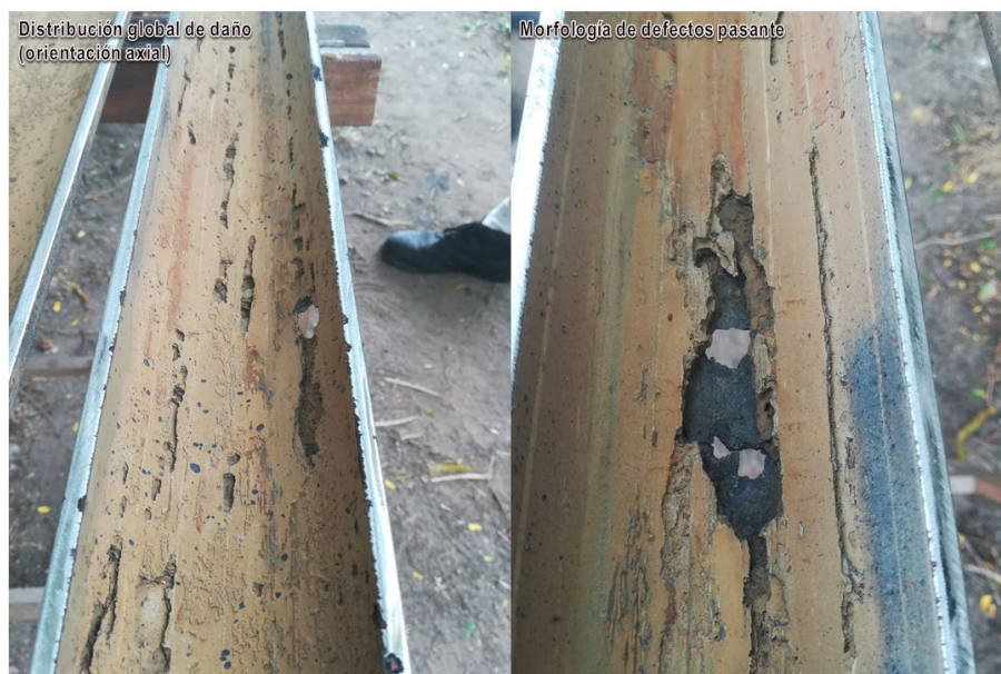
Figura 25. Daño identificado en tubulares con formación de agua condensada. Izquierda: distribución axial y radial. Derecha: defecto pasante.
