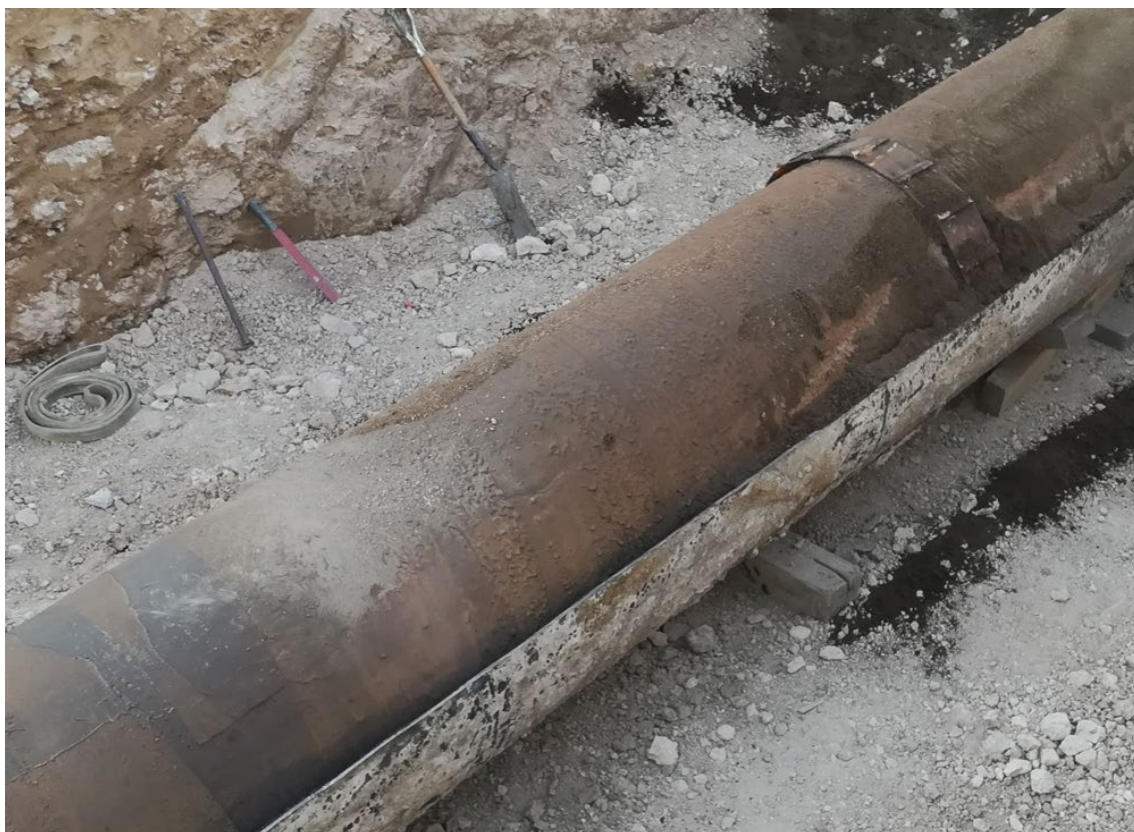
Fig. 6 – Intervención de caño camisa, donde se ve el centrador y la coloración y el daño causado en el ducto.
