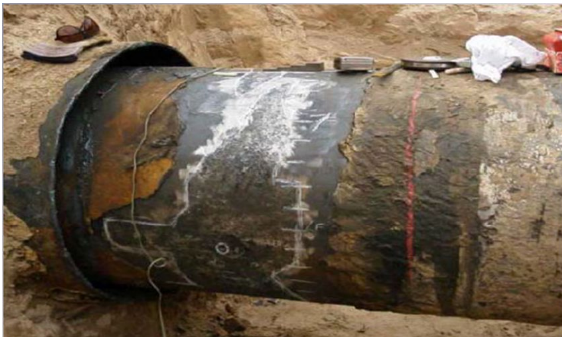
Fig. 4 - Imagen del daño causado por ingreso de electrolito al espacio anular.
