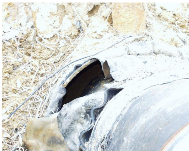
Fig. 2 - Falla en Sello entre ducto de conducción y caño camisa.
