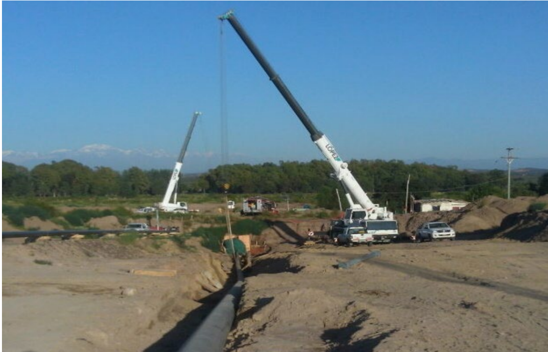
Fig. 8 – Intervención en ruta 62
