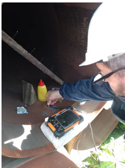
Figura 2. Evaluación de la corrosión
