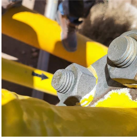
Ilustración 8 – Daño por acción de erosión
