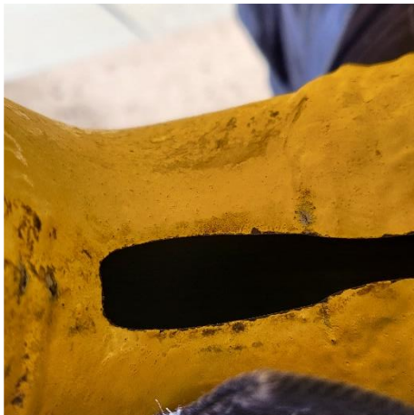
Ilustración 7 - Rotura en Tee
