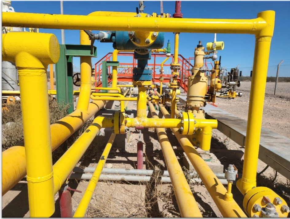
Ilustración 6 – Vista de instalación – By pass de calentador
