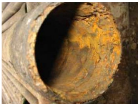
Figura 10. Erosión corrosión CO 2 (PAE 2007)
