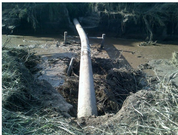
Figura 10. Flexión por arrastre en una cañería expuesta
