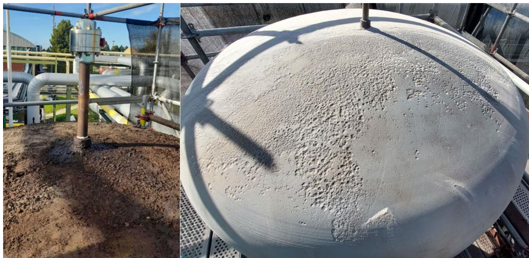
Figura 33: Casquete y acometida superior afectados por CUI – Complejo Cerri
