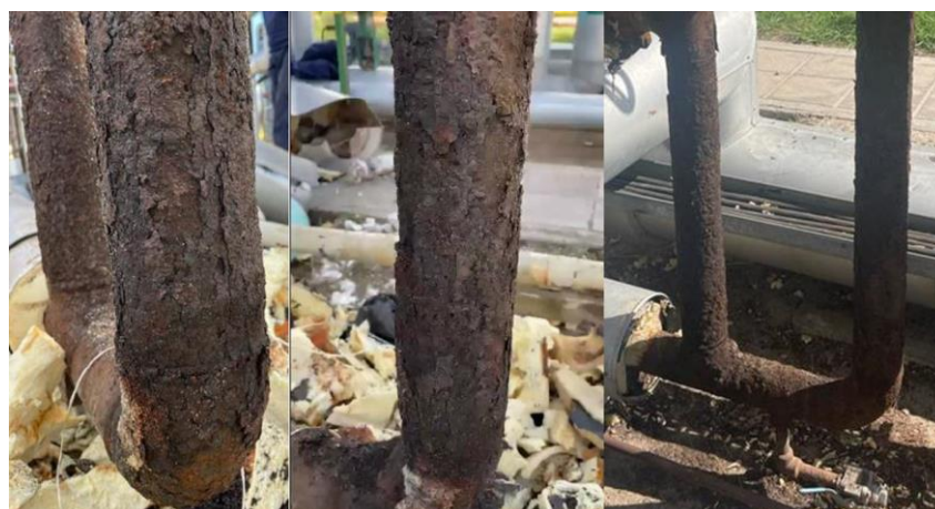
Figura 11: Líneas desaisladas verticales en zona de fuga – Planta de producto refrigerado
