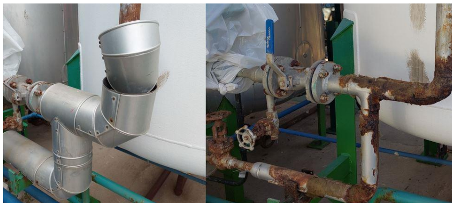
Figura 26: Montaje inadecuado - Líneas Planta Ecoenergía
