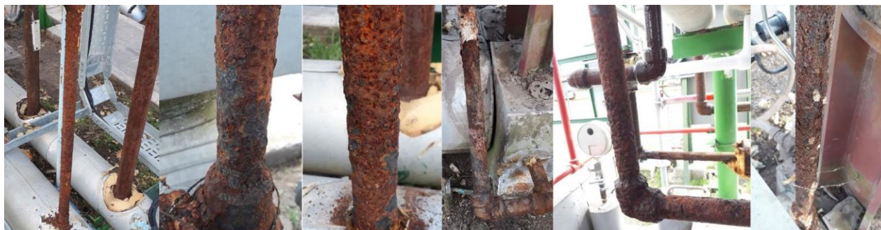
Figura 10: Líneas desaisladas planta de producto refrigerado II
