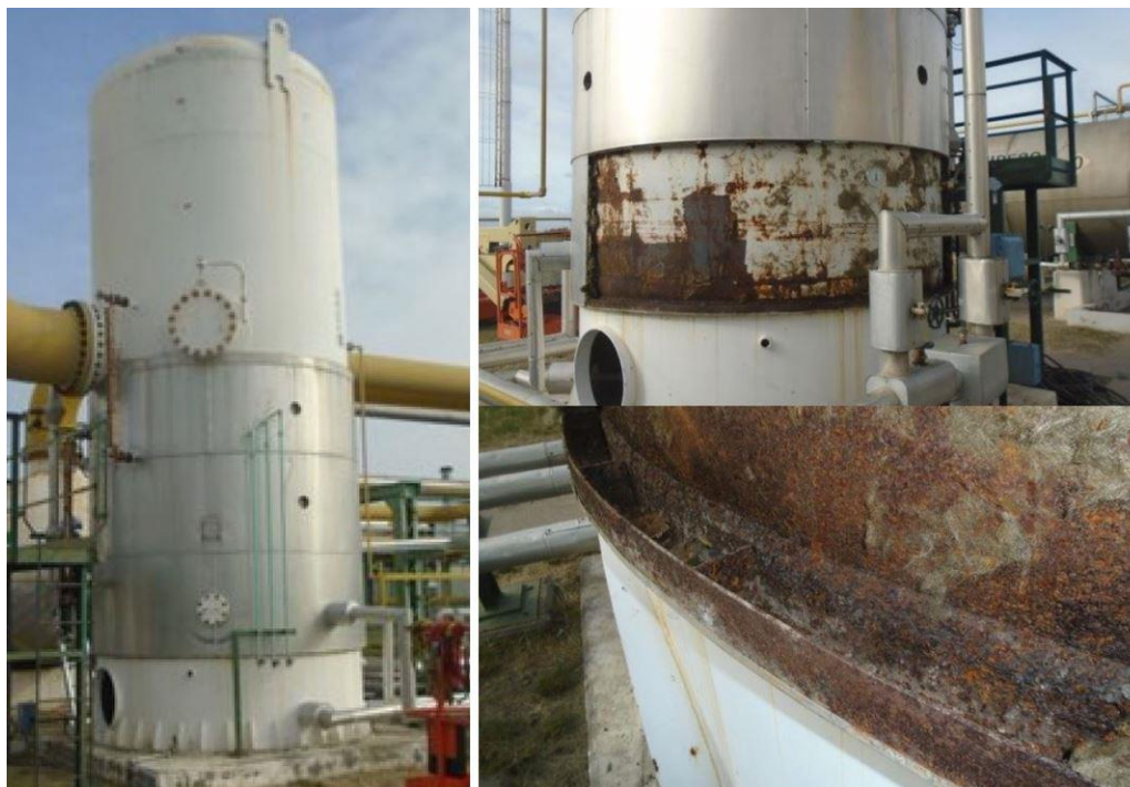
Figura 31: Zonas afectadas por CUI en equipos con aislación parcial en zonas susceptibles – Complejo Cerri
