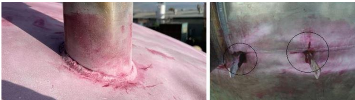
Figura 23: Fisuras en acometidas y Accesorios - Torre desaeradora Planta Ecoenergía
