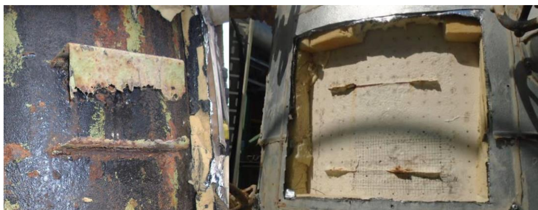
Figura 32: Placa de identificación afectada por CUI – Complejo Cerri
