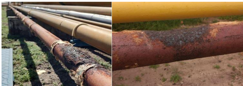
Figura 20: Línea con hundimiento estructural – Planta Solar
