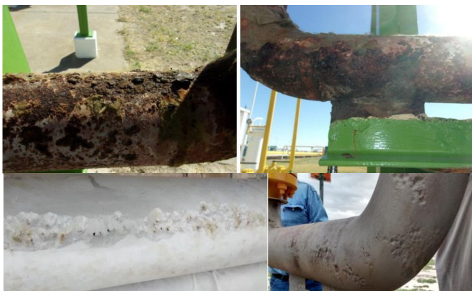
Figura 16: Zona con picaduras pasantes – Planta Solar
