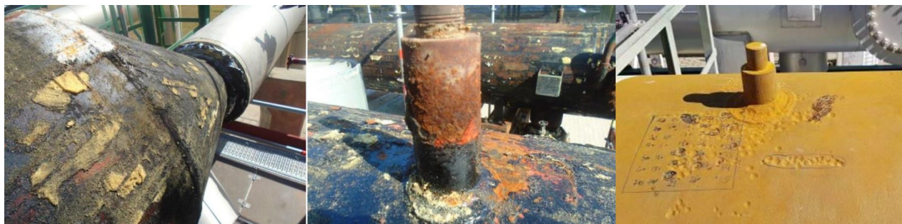
Figura 28: Zonas afectadas por CUI en intercambiador de calor I en zonas susceptibles a temperaturas críticas – Complejo Cerri
