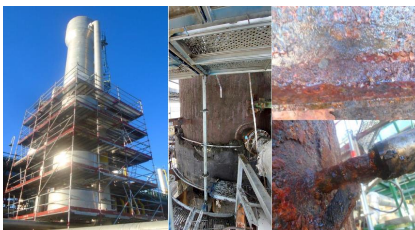
Figura 30: Zonas afectadas por CUI en torres por ausencia de esquema de pintura – Complejo Cerri
