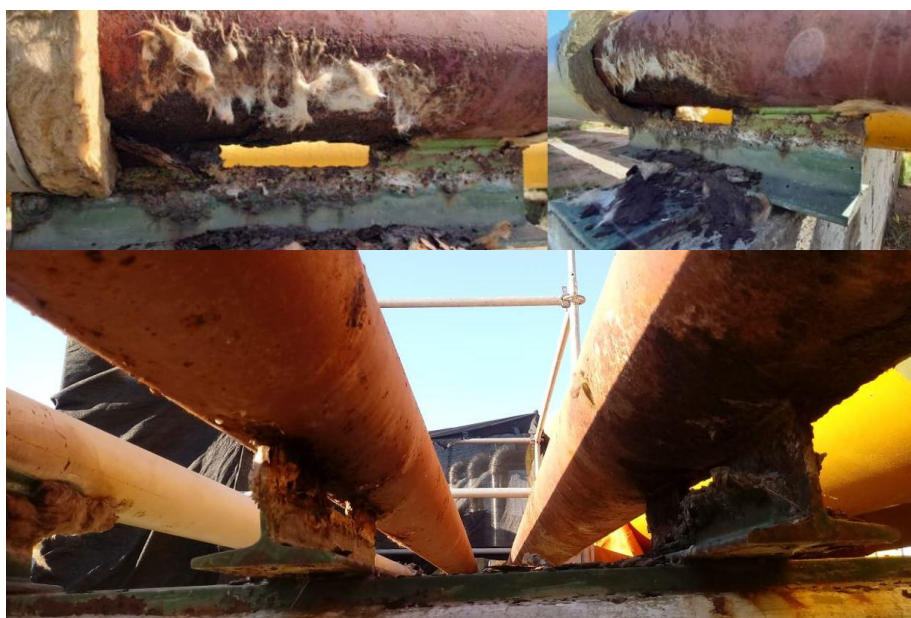
Figura 19: Líneas sin esquema de pintura en zonas de soportería – Planta Solar
