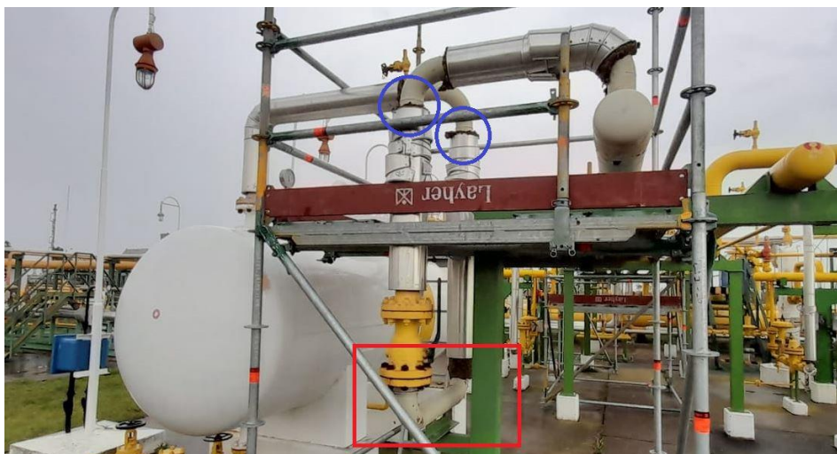
Figura 15: Indicaciones localizadas en Planta Compresora Solar
