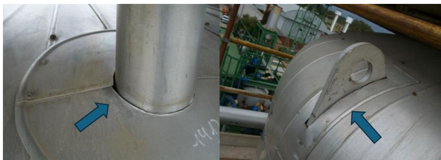
Figura 25: Falta de sellado en chapas de protección mecánica - Torre desaeradora Planta Ecoenergía
