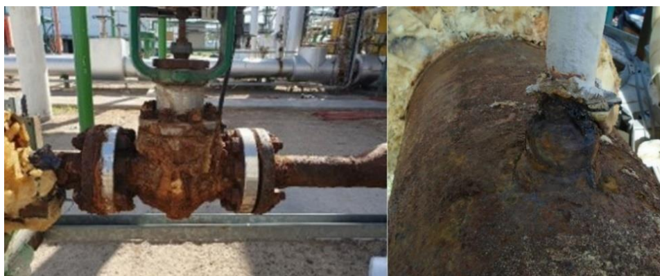
Figura 13: Otras zonas susceptibles a CUI en líneas – Planta de producto refrigerado
