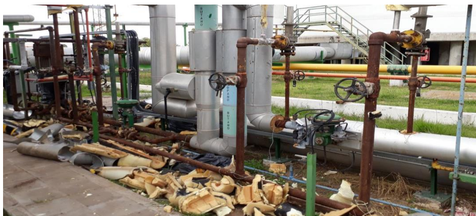
Figura 9: Líneas desaisladas planta de producto refrigerado
