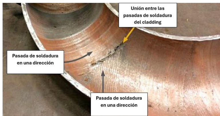
Fig. 21: Segundo caso de estudio: codo con cladding de soldadura de níquel.
