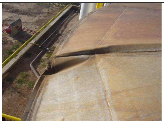
Figura 3. Deformaciones en Techo
