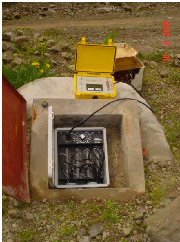
Figura 22. Caja de medición y unidad lectora
