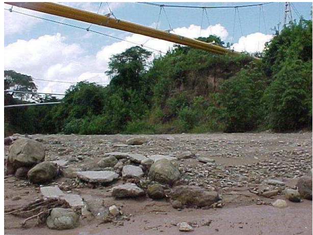
Figure 10: cruce aéreo de 110 m de luz
