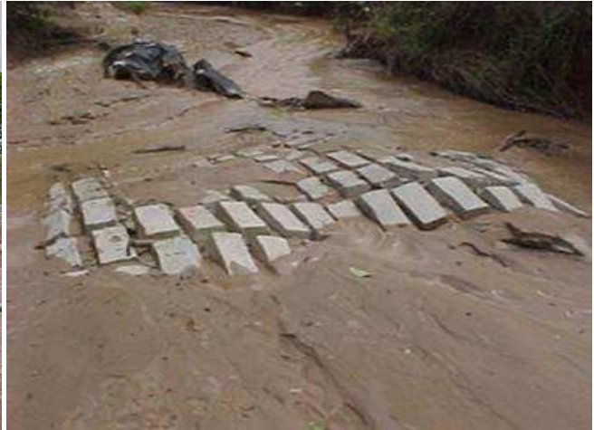
Figure 24: mantas con bloques deformadas
