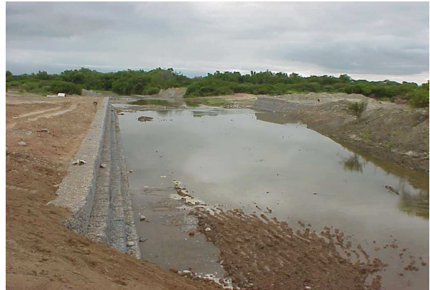
Figura 39: muros de gaviones en ambas márgenes
