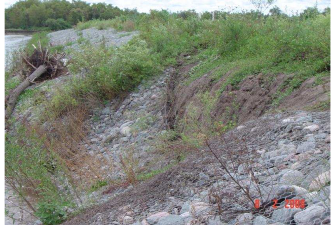
Figura 37: derrumbe por erosión al pie
