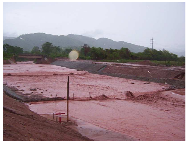
Figura 26: obra en funcionamiento
