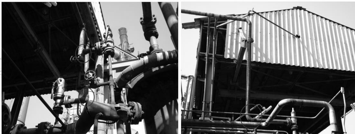
Figura 6. Válvulas de alivio con descargas a sistema cerrado sin drenaje libre
