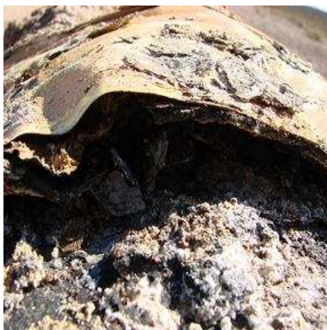
Fig. N° 8: Celda de Corrosión Debajo de Revestimiento Despegado
