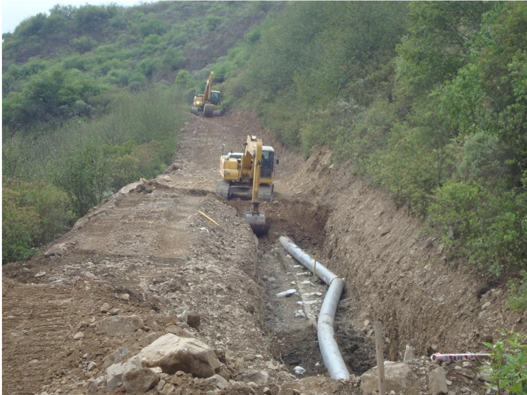
Fig 7. Deformación brusca de la cañería una vez excavados los primeros 27 m en la zona topográficamente más baja del talud.
