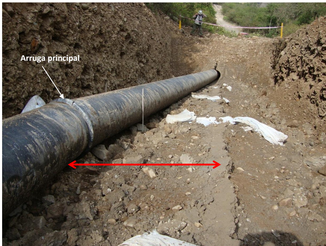
Fig 8. Desplazamiento de la cañería fuera de la cuna en un valor cercano a 1,25 m.
