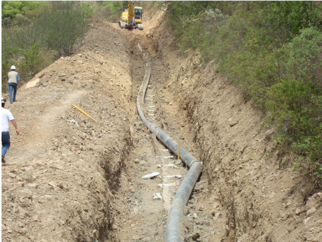
Fig 9. “Serpenteo” de la cañería a medida que se prosigue con la liberación como producto de tensiones acumuladas.
