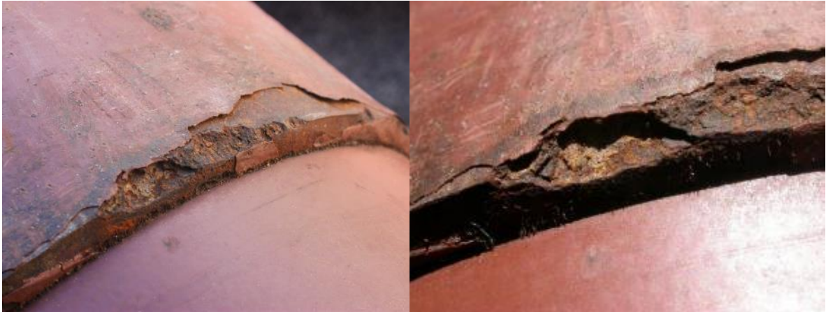
Fig. 5. Desprendimiento de coating y corrosión con pérdida de material en el borde de junta del lado 1B.
