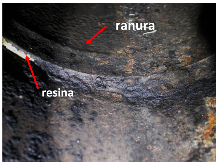
Fig. 16. Remanentes de resina epoxi con desprendimiento parcial del excedente y ranura de sello de resina
