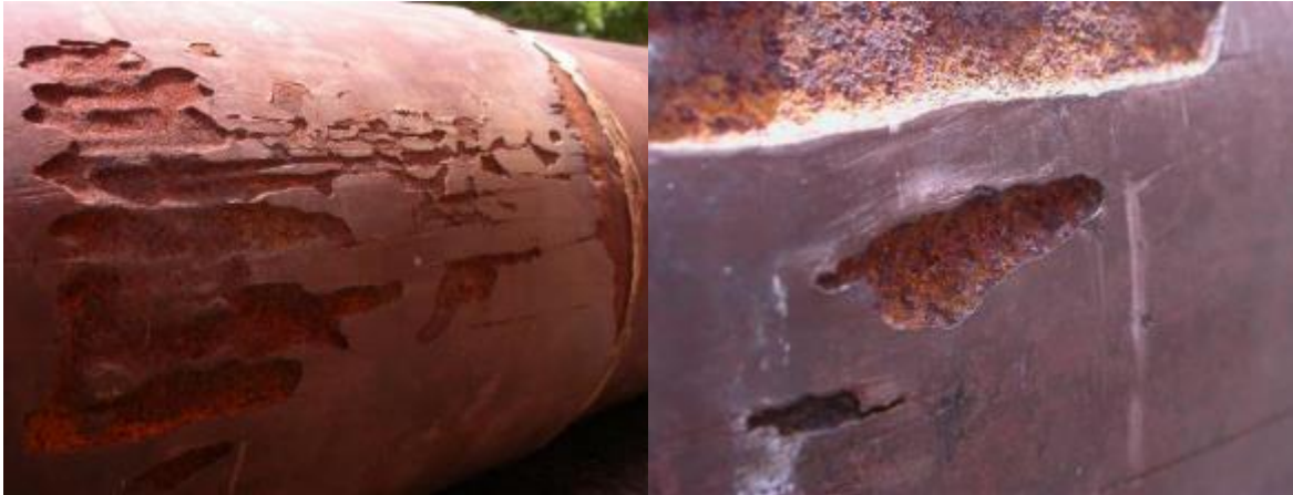
Fig. 13. Desprendimiento de coating y corrosión con pérdida de material en el cuerpo de la muestra 3.
