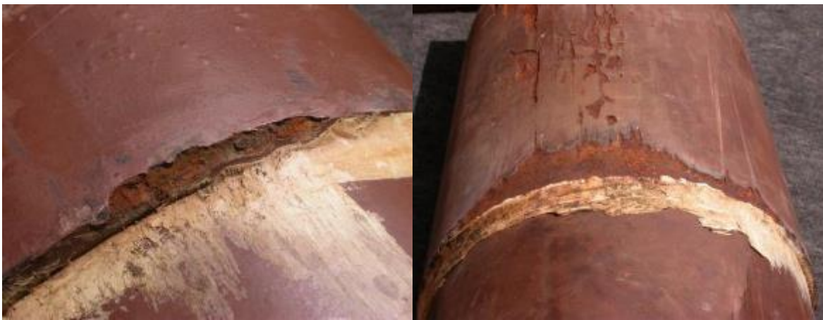
Fig. 14. Desprendimiento de coating y corrosión con pérdida de material sobre el borde de junta 3B. Puede apreciarse la resina que recubre el borde y se presume posterior al embonado de los caños.
