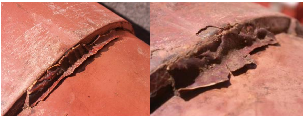
Fig. 6. Remanentes de resina epoxi del embonamiento en el borde de junta del lado 1B.
