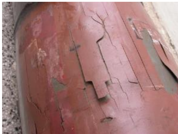
Fig. 26. Muestra 1, post ensayo. Debonding del coating caño B debido a la deformación plástica.
