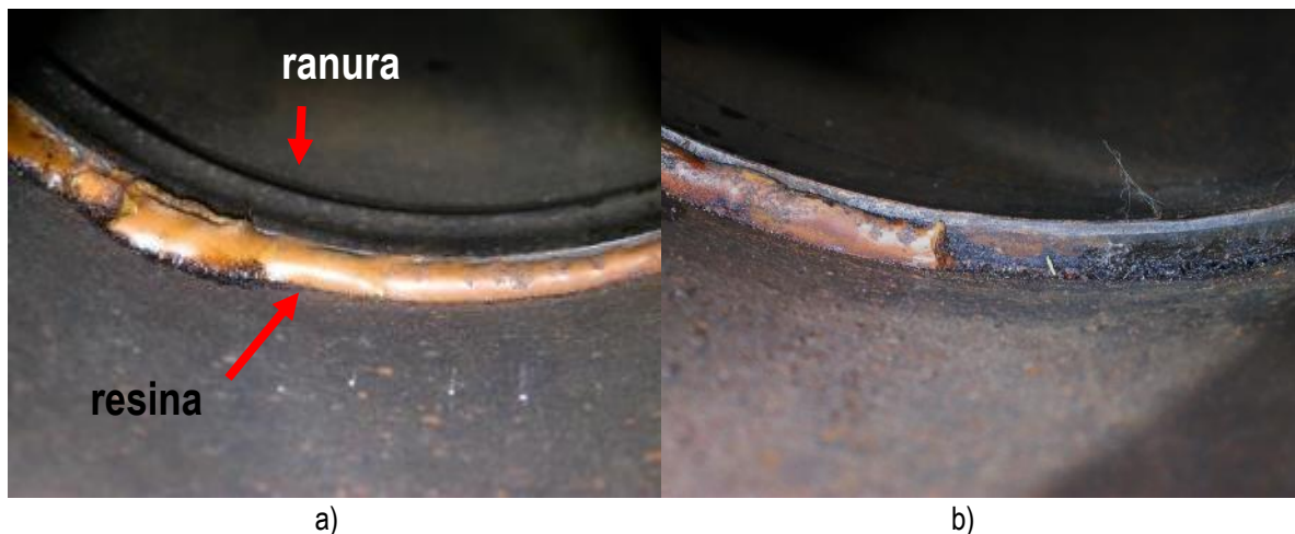
Fig. 7. a) remanentes de resina epoxi en el borde de junta del lado 1A. Detrás, el pliego de la ranura de almacenamiento de resina. b) Zonas de dicho borde con desprendimiento de resina.
