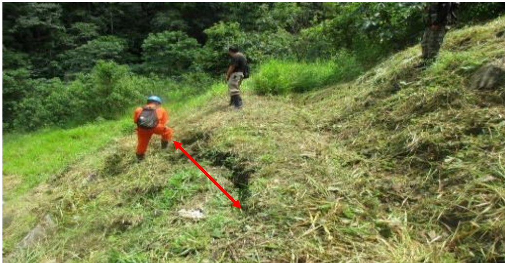
Figura 6: Grieta que evidencia actividad del suelo sobre el DDV (largo:8m, ancho:0.3m, profundidad:0.5m)
