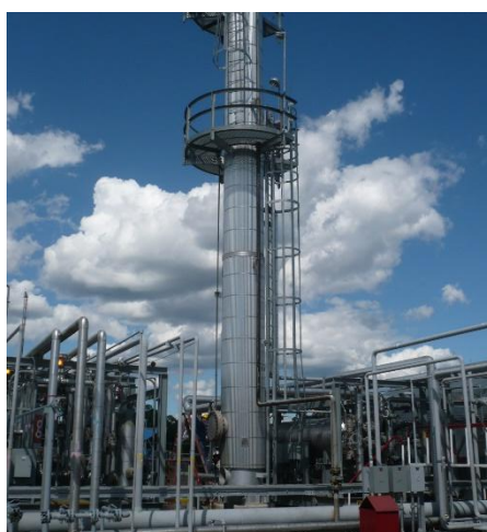
Figura 7. Planta de tratamiento de gas.
