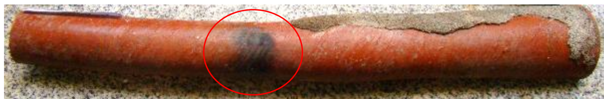
Figura 3.2: Superficie exterior del niple. Se observa la porción con cemento adherido y la zona infiltrada, rodeada por un círculo.
