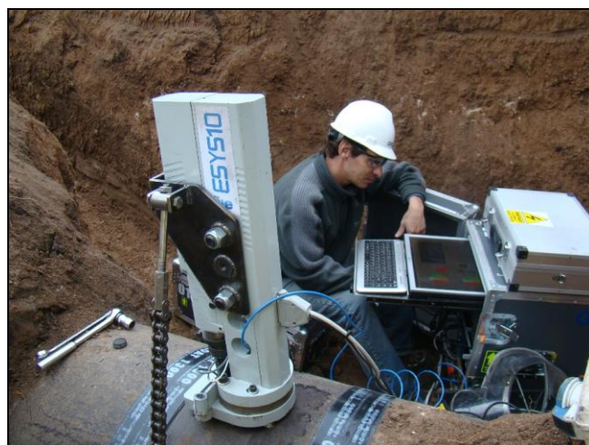
Figura 11. Indentación en gasoducto 24''.
