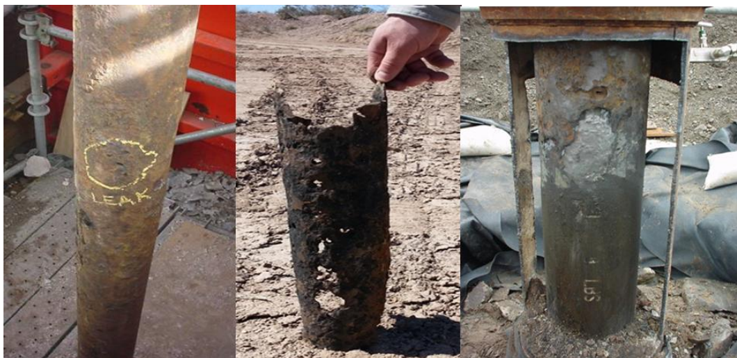
Figura 1. Daño por corrosión externa de casing
