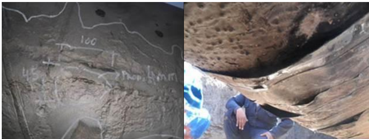
Imagen 1. Corrosión externa debido al apantallamiento de revestimientos de cintas.
