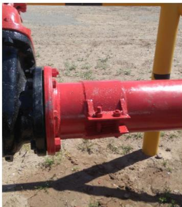
Figura 13.- Reparación en la red de incendio con problemas de pérdida de espesor interior
