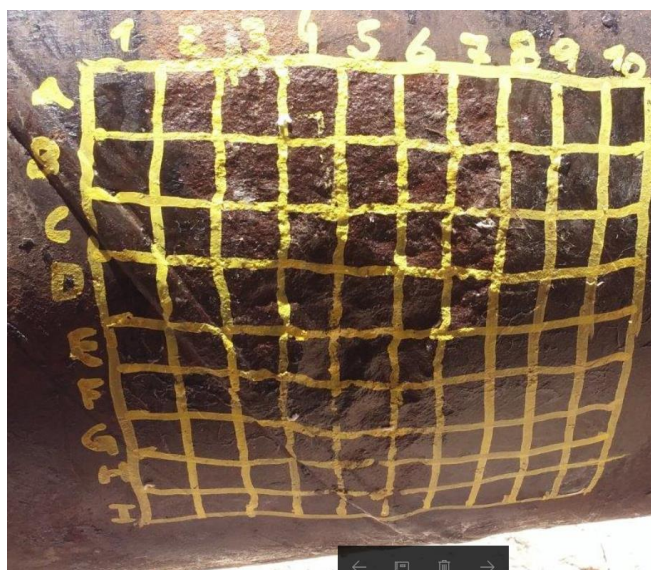
Figura 11.- Corrosión externa en cañería de aspiración.
