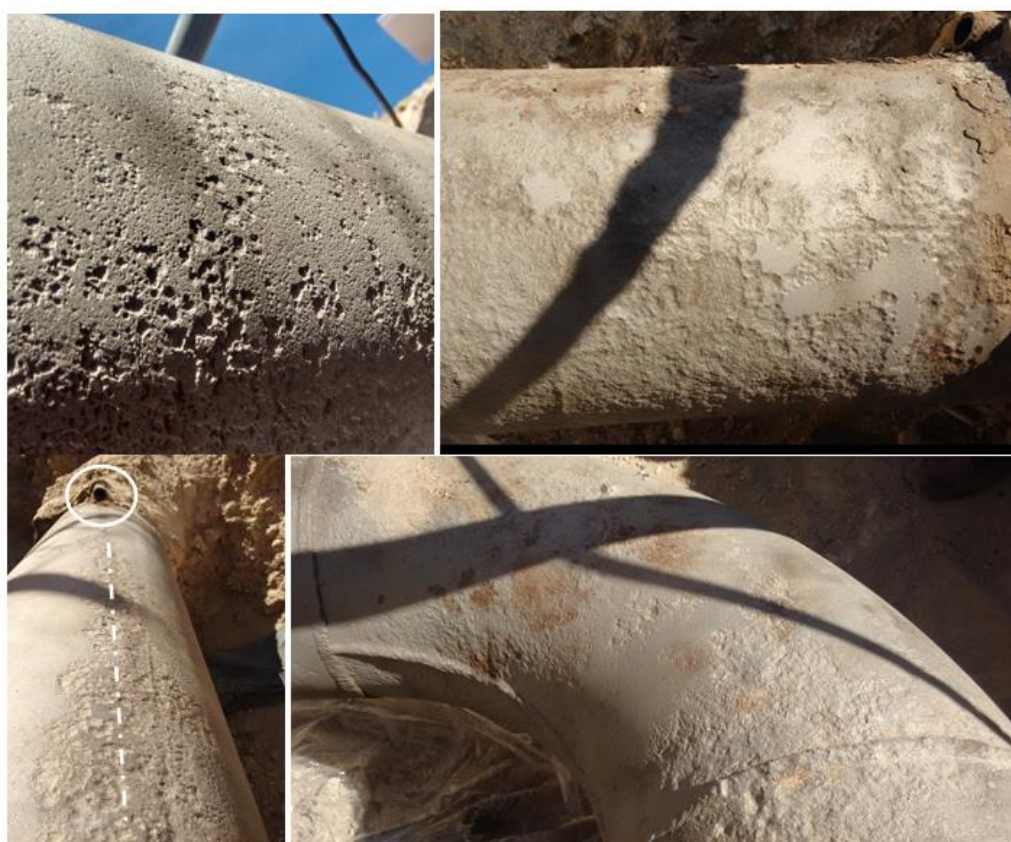
Figura 9.- Corrosión externa generalida y corrosión galvánica en cañería de ingreso y egreso de tanques de almacenamiento.
