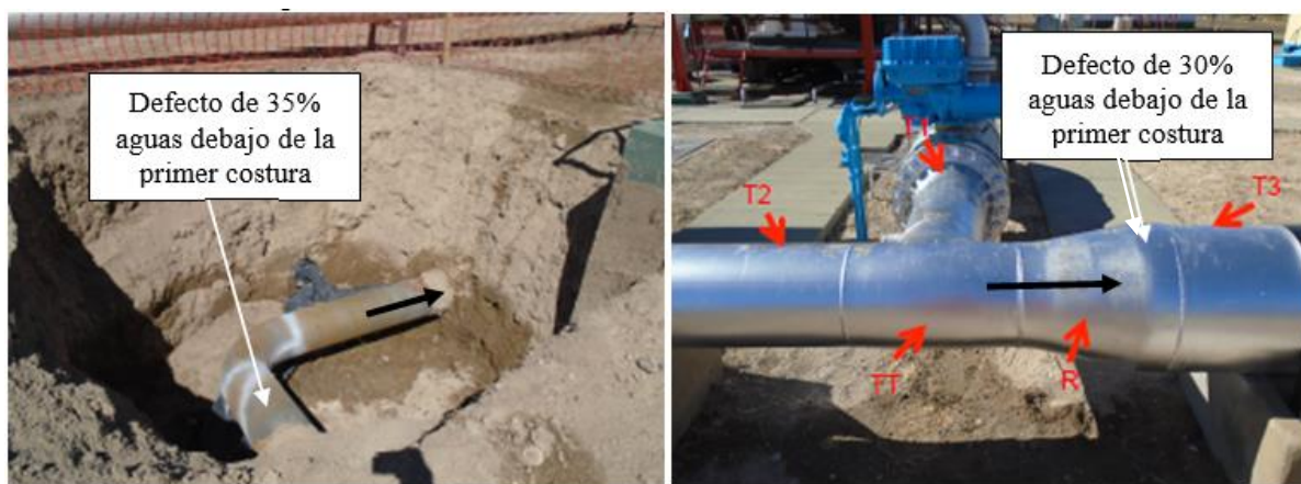
Figura 8.- A la izquierda, defecto de erosión en cañería de descarga, aguas debajo de accesorio tipo codo 90°; A la derecha, defecto de tipo erosión aguas debajo de la reducción de \varnothing n=14'' a 20''.
