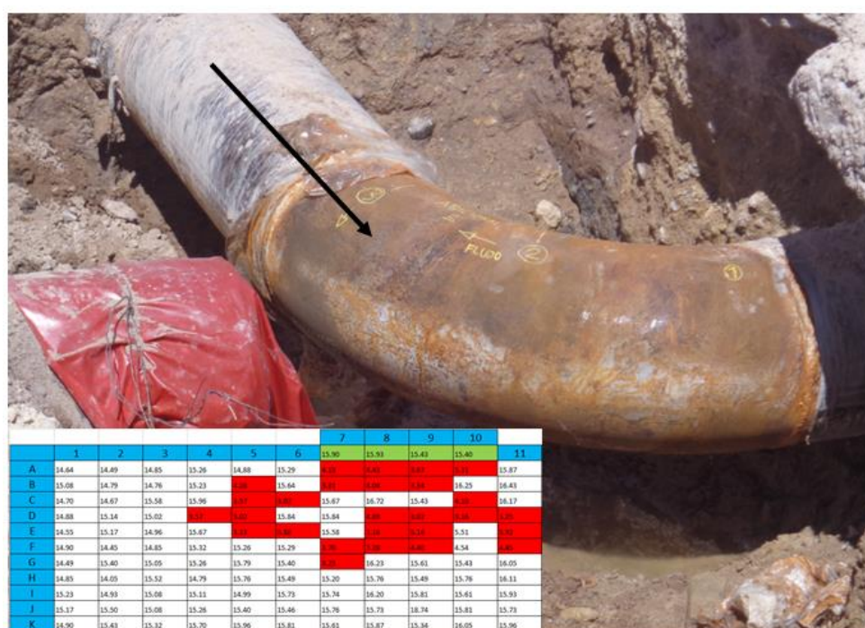
Figura 7.- Defecto de erosión en codo de descarga. No presenta deterioro externo, pero desde el punto de vista interno presentaba una pérdida de metal del 81%.
