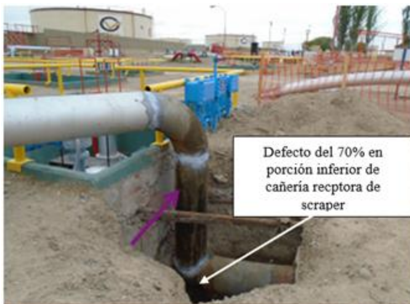
Figura 10.- Corrosión interna en cañería sin circulación.
