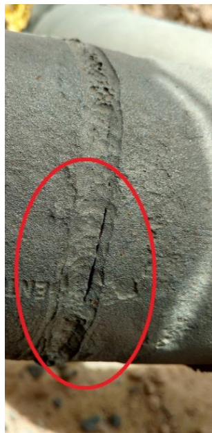
Figura 12.- Corrosión externa en cañería de drenaje
