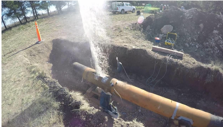
Fig. 19 Momento de rotura de la prueba hidráulica.
