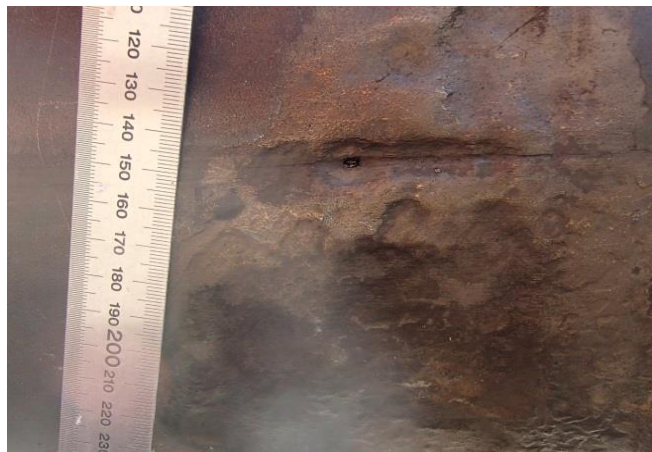
Fig. 6 Corrosión selectiva en línea Salitral-Puerto Rosales
