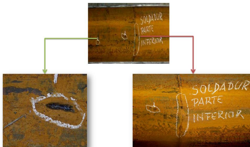
Figura 7. Evidencia de corrosión microbiológica, análisis de falla.
