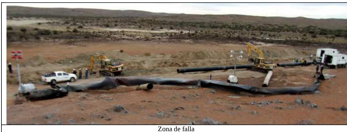
Figura 1.- Cañería afectada por la falla
