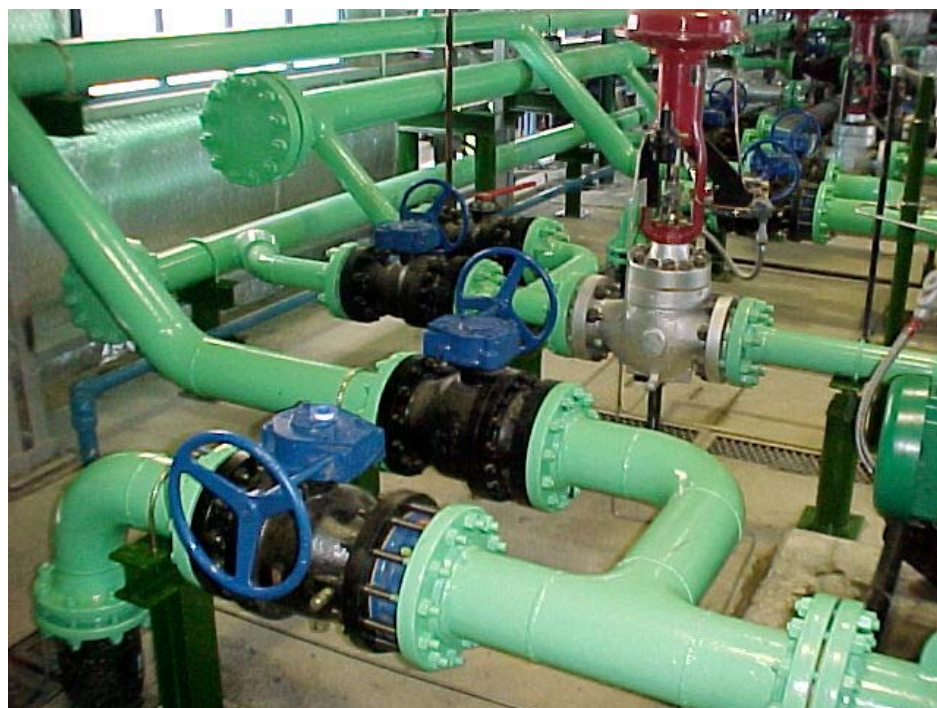
Foto 03: Vista de válvulas de bloqueo en aspiración y reguladora en impulsión
