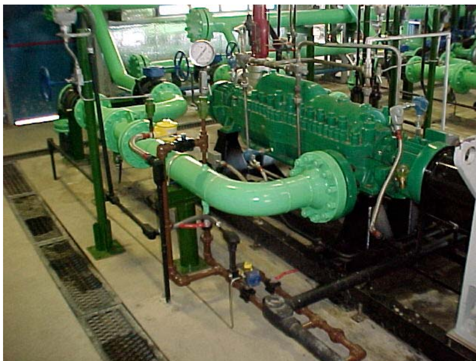
Foto 02: Vista de cañería de agua de ingreso a bomba multietapa de inyección
