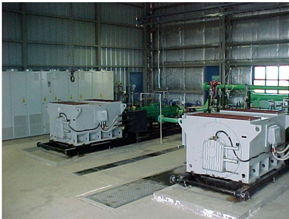
Foto 01: Vista de conjunto motor eléctrico – bomba multietapa de inyección
