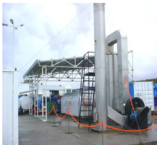
Ilustración 10. Torre lavadora de gases y chimenea del Equipo de Termodestrucción
