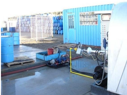
Ilustración 9. Quemadores del Equipo de Termodestrucción
