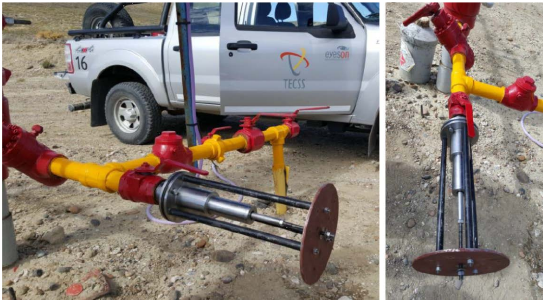
Figura 21: Dispositivo construido, instalado en el puente de producción de un pozo.
