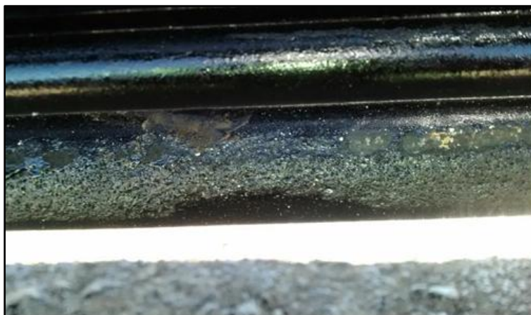
Ilustración 10: Cuerpo de varillas- depósitos de Carbonatos de Fe
