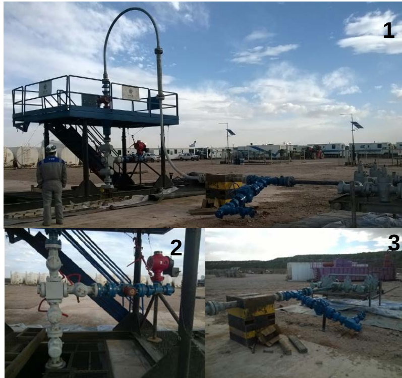
Fig.13. Pozo Horizontal: Sistema de terminación con camisas deslizables. La boca de pozo contempla: 1. Omega. 2. Ball Launcher. 3. Ball Catcher
