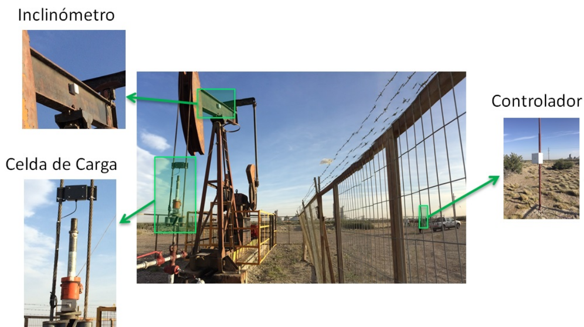
Figura 2: Instalación del sistema en el pozo PT-089 del yacimiento Pico Truncado operado por YPF.
