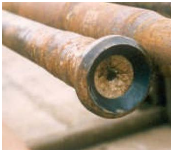
Figura 9. Tubing obstruido con incrustaciones.
