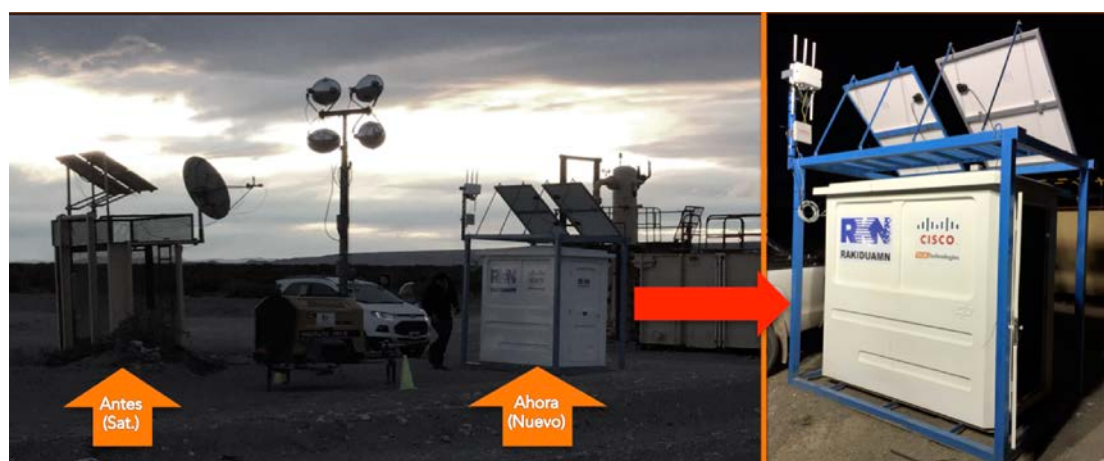
Figura 27. Gabinete en el sitio remoto
