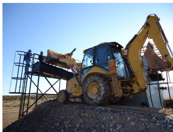
Carga de Cloruro de Magnesio
