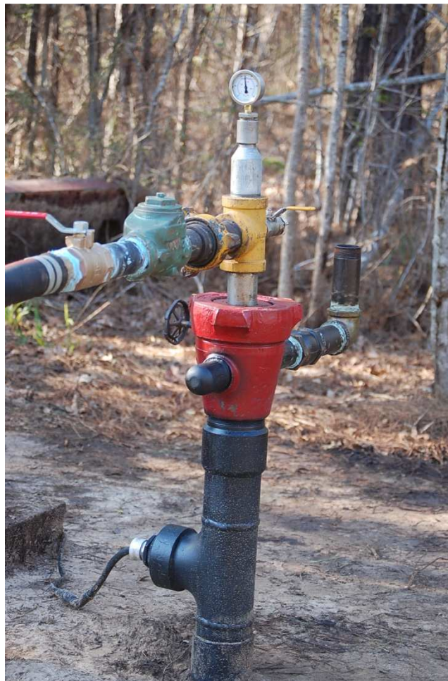
Tubería de producción acoplada con accesorios de 2"SS a una cabeza de pozo convencional
