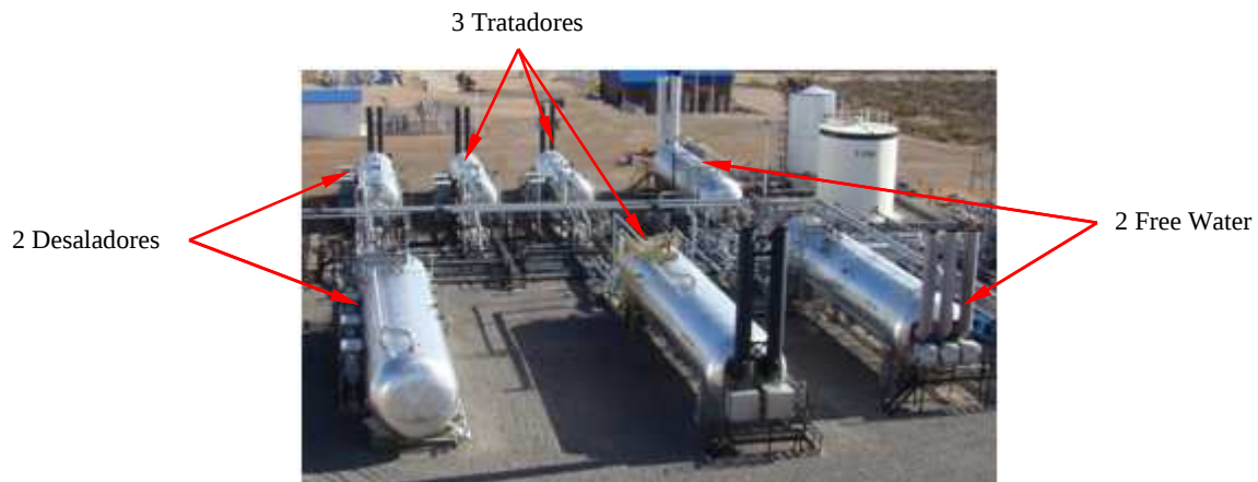
Figura 12 – Vista general de PTC - ECN
