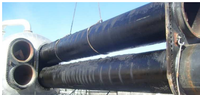
Figura 20 – Acumulación de arena en Tubos de Fuego
