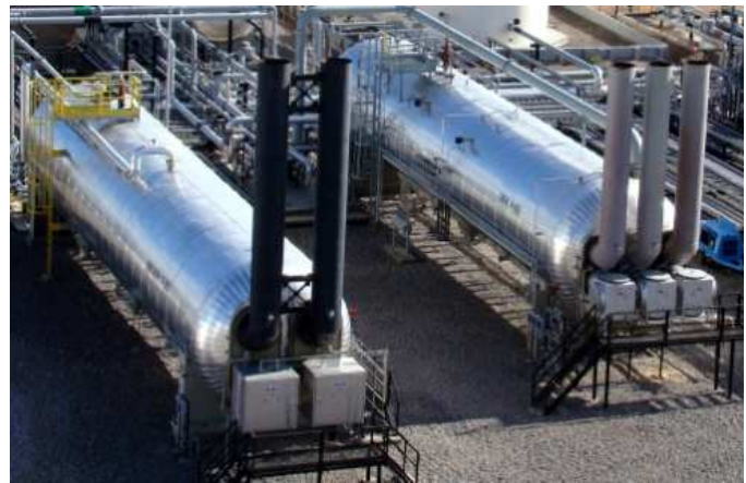
Figura 3 – Quemadores y chimeneas
