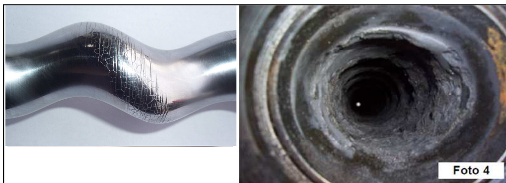
Figura 4: Izquierda: rotor agrietado; Derecha: Elastómero vulcanizado
