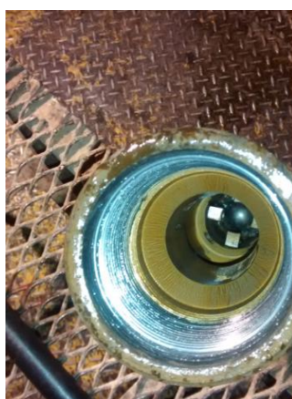
Foto 2: Bola de Válvula CDF asentada
